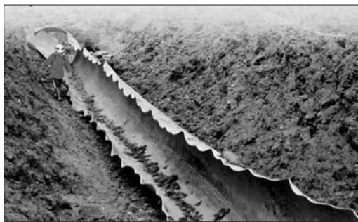
1. Характер типового руйнування магістрального газопроводу
